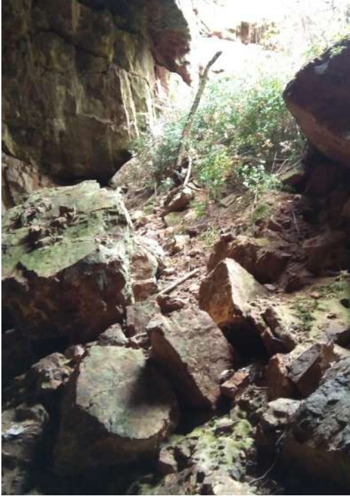
Evidencias del derrumbe de los techos.
